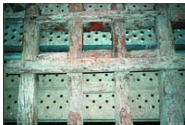
Foto 22 Parte de la estructura eliminada por falta de resistencia
