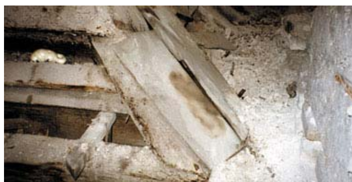
Foto 29 Trasdós esquina suroeste. Acumulación de escombros
