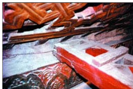
Foto 19 Rotura del estribo en la unión con el tirante. La desecación de la madera origina una falta de resistencia que deriva en rotura de aquellas zonas más sensibles, aquellas en las que se reducen las secciones y que están sometidas a fuerzas locales
