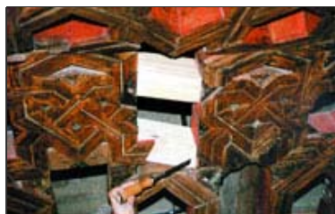
Foto 24 Operación de reposición de peinaos en los pares deformados. Se apreciaba con claridad la dificultad a la hora de encontrar el correcto enlace de los mismos debido al desplazamiento de la alfarda deteriorada
